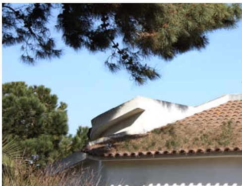
Figura 12 — Pinheiro-bravo com projecção da copa sobre a cobertura da casa e com acumulação de caruma no telhado.
